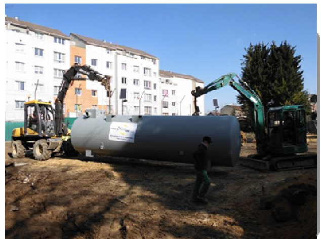
Vue de la cuve
