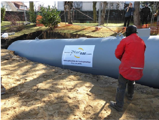
Vue de la cuve
