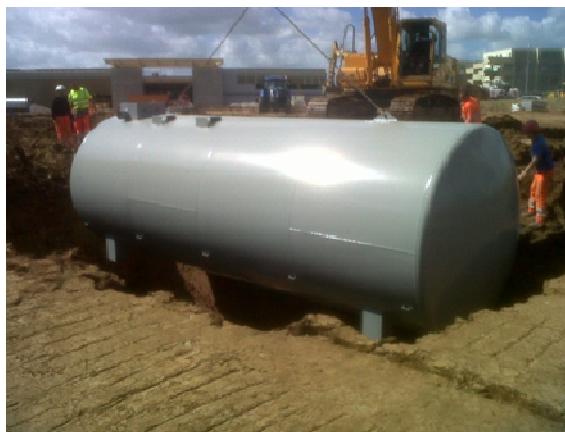
Vue de la cuve
