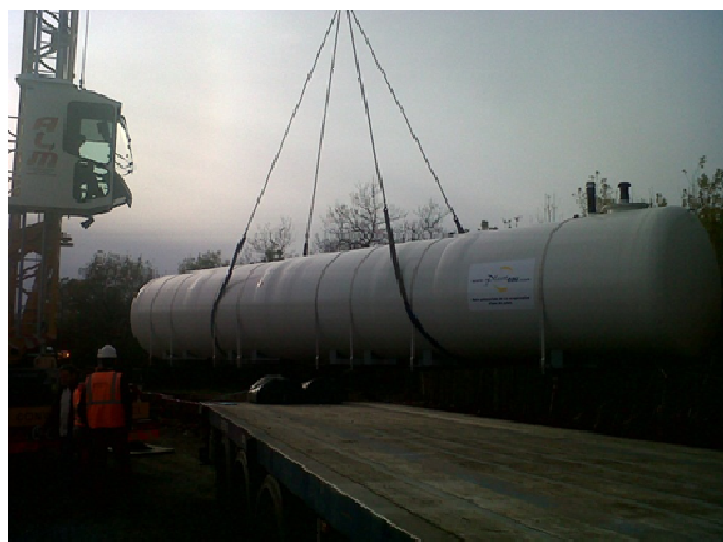
Vue de la cuve
