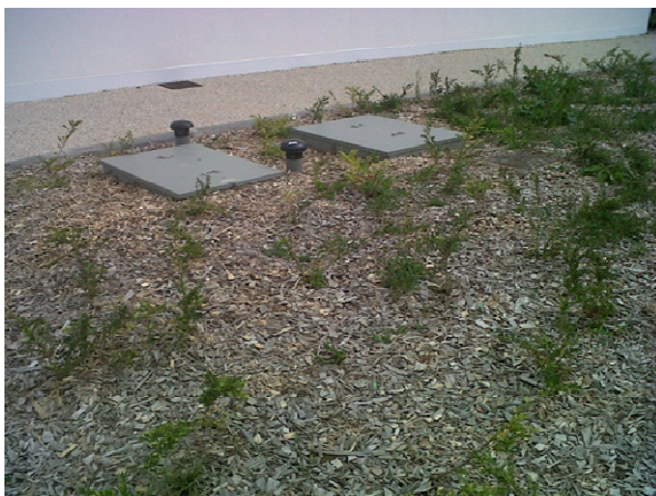
Vue de la cuve posée
